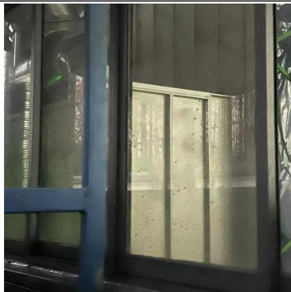
过滤棉+干式过滤器
